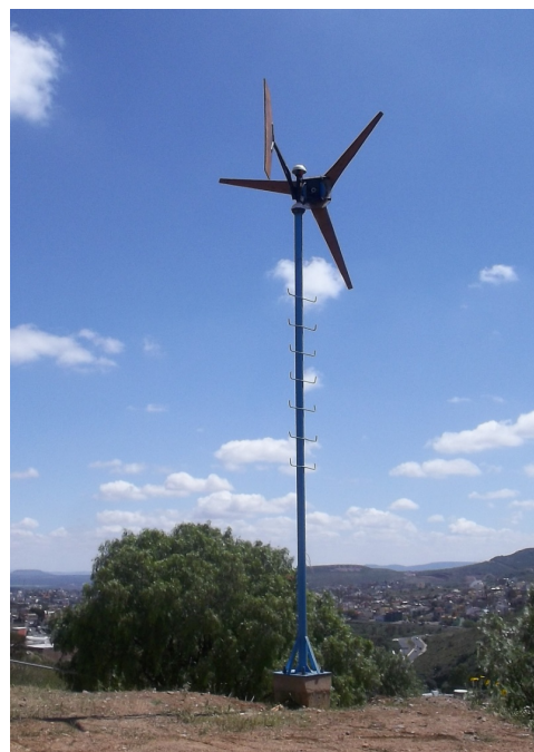
Figura 14. Emplazamiento en campo del sistema eólico.
