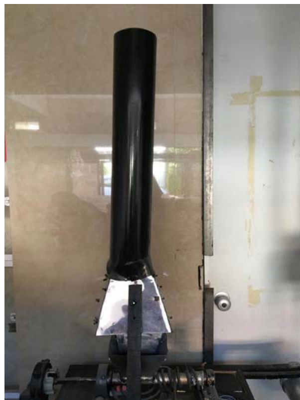
Figura 5: Sistema de Extracción de Gases de la extrusora plástica
